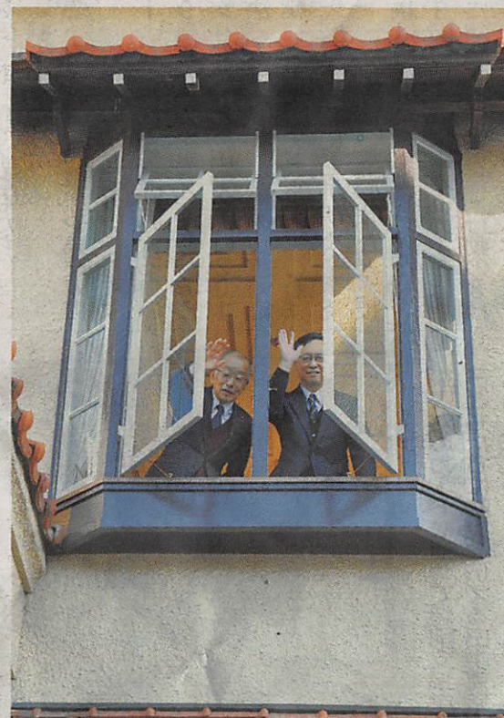
修繕が終わり、窓が開いた桐生倶楽部会館2階大広間の出窓
